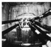
マンホール 内設備調査 システム
